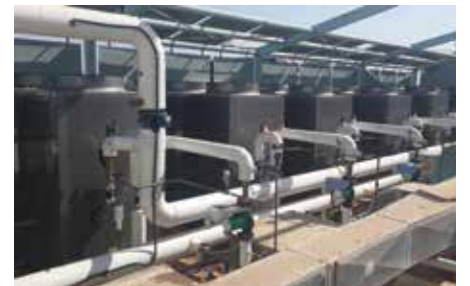
מערכת חימום מים מרכזי ל-75 מ"צ, בדיר מונן פלאס רעננה, מקבוצת עזריאלי.
